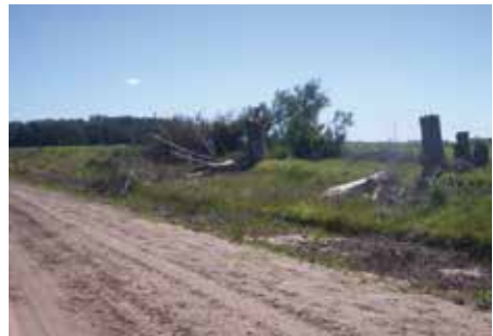
Imagen N° 6 - Desagüe longitudinal obstruido por ramas y malezas
