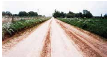
Imagen N° 9 - No hay suelo disponible para conformar el terraplén
