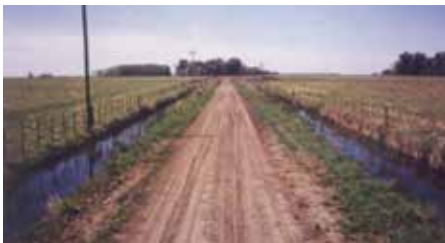
Imagen N° 8 - No hay suelo disponible para conformar el terraplén
