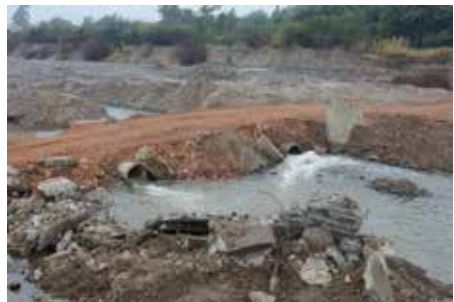
Imagen N° 17 - Alcantarilla con alto proceso de erosión
