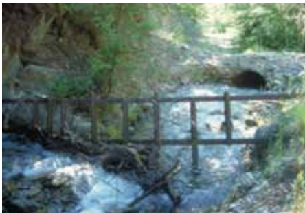
Imagen N° 19 - Rejas de protección en entrada de alcantarilla
