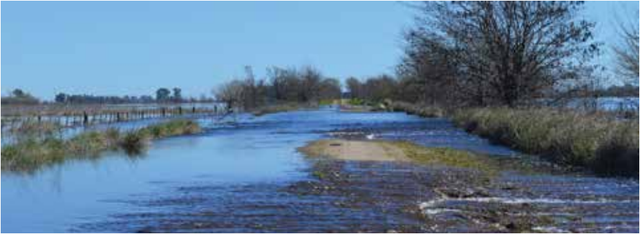
Imagen N° 2 - Debido a la falta de un perfil adecuado se deposita el agua en la calzada
