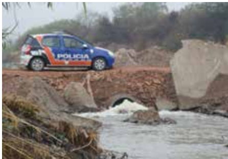
Imagen N° 18 - Alcantarilla transversal con fuerte erosión en taludes de cabecera
