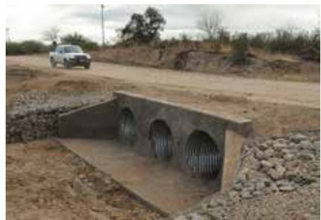
Imagen N° 15 - Alcantarilla transversal de sección múltiple
